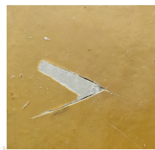
图3 附着力检测 发现存在层间剥离现象
