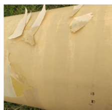
图2 运行一段时间后 后涂层面层脱落
