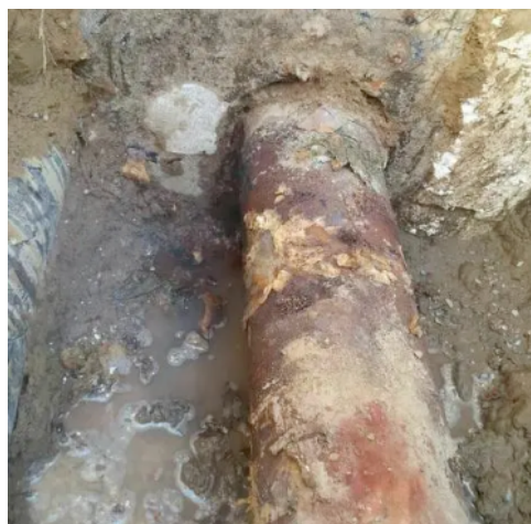
图 1 燃气管道被腐蚀
