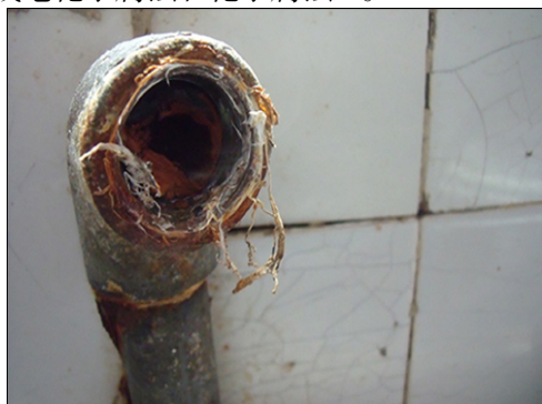
图2 天然气管道内腐蚀
