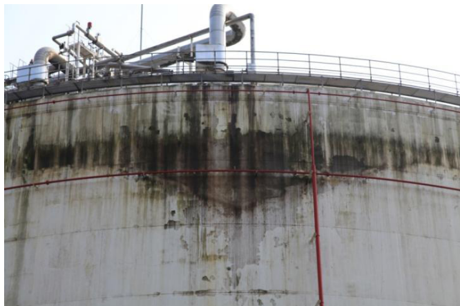
图2 LPG 低温储罐漏冷带
