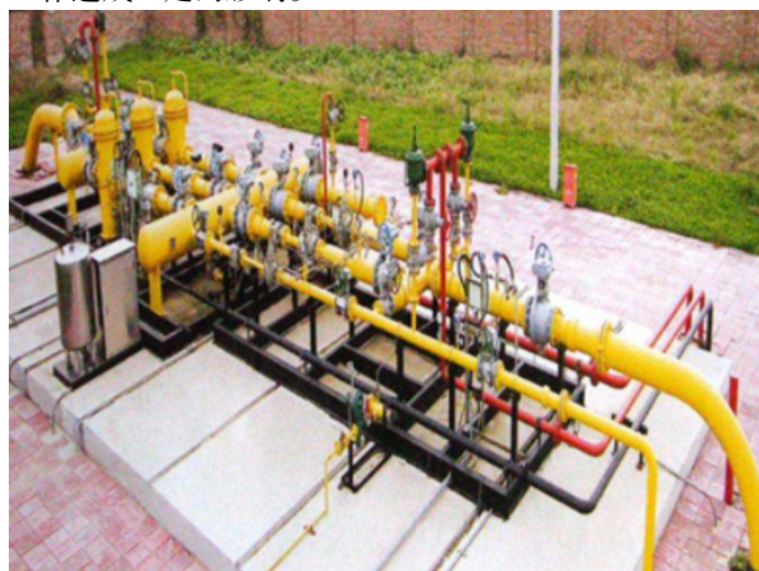
图 1 城市燃气调压站
