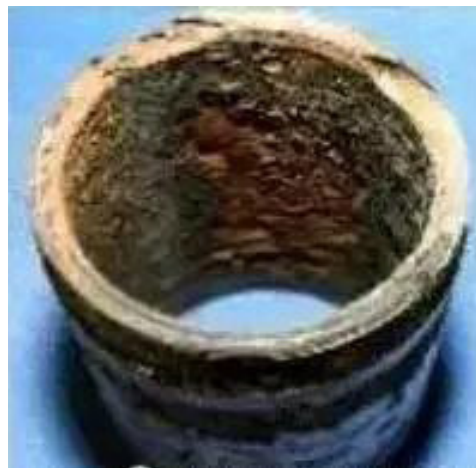
图 3 油气管道腐蚀
