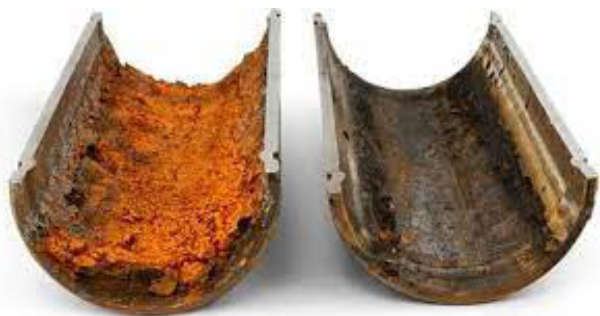
图1 已经出现腐蚀的石油管路
