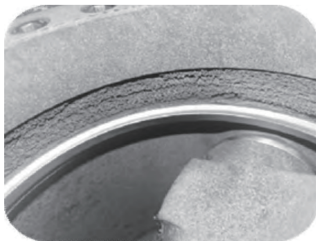
图 2 铸造阀体腐蚀照片
