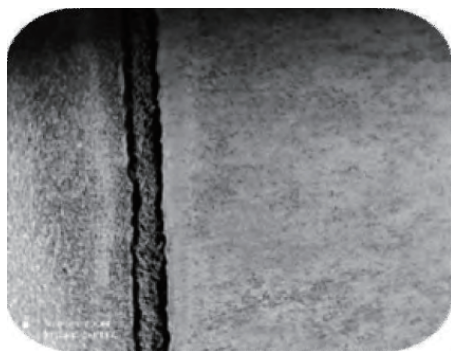
图 1 管道内部焊缝腐蚀照片
