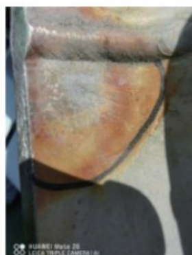
管线弯头内部腐蚀小孔
