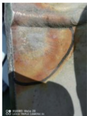
管线弯头内部腐蚀小孔
