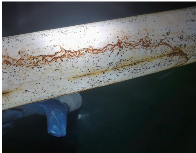
图 1 模压管道泄漏
