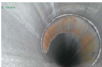
图 2- 浮锈(管道上部)
