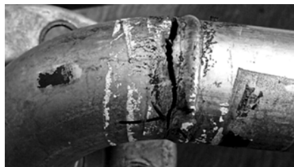
图 1 生产管道腐蚀图
