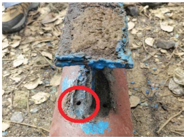
图1 焊接管托部位腐蚀穿孔图
